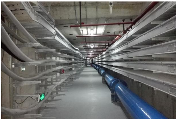
图 1.1 综合管廊内部实景
